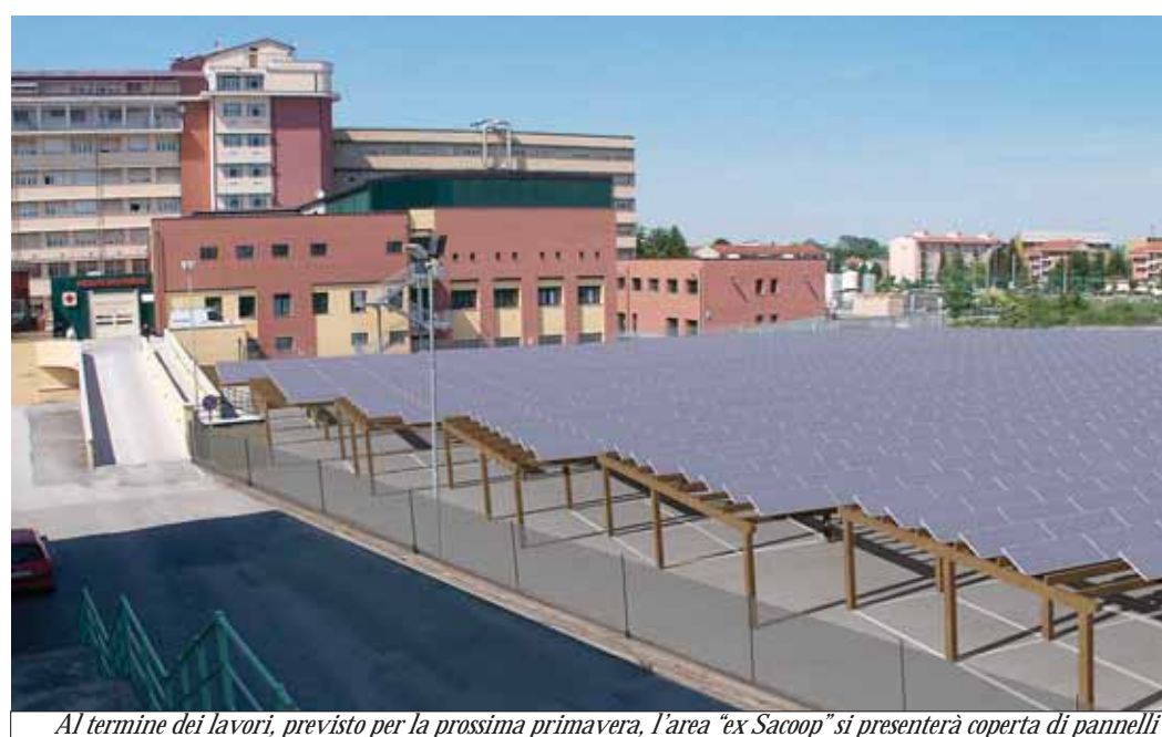
Al termine dei lavori, previsto per la prossima primavera, l'area "ex Sacoop" si presenterà coperta di pannelli
